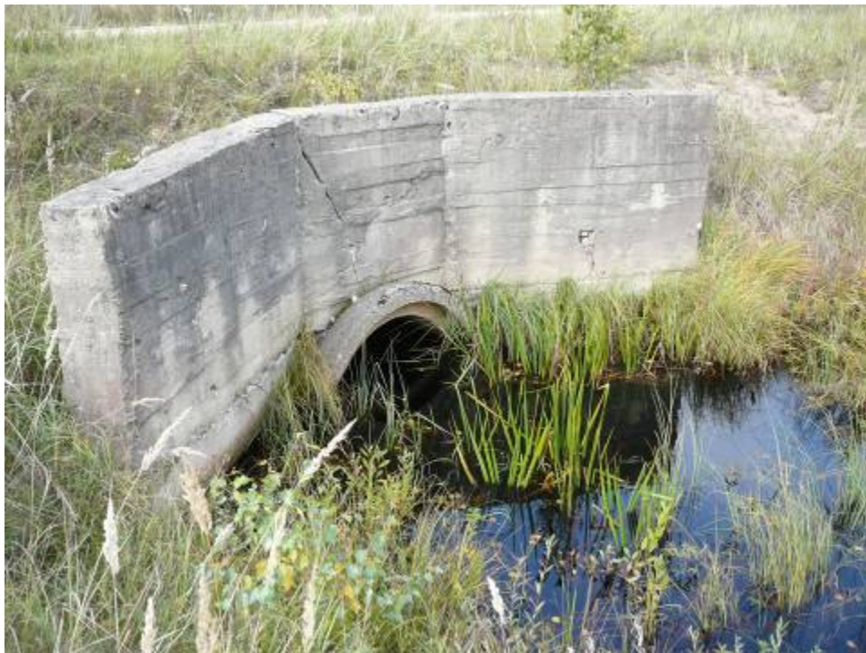
Caurteka C-44, gala sienas apmierinošā stāvoklī. Cauruļu aizsērējums ~30%.
