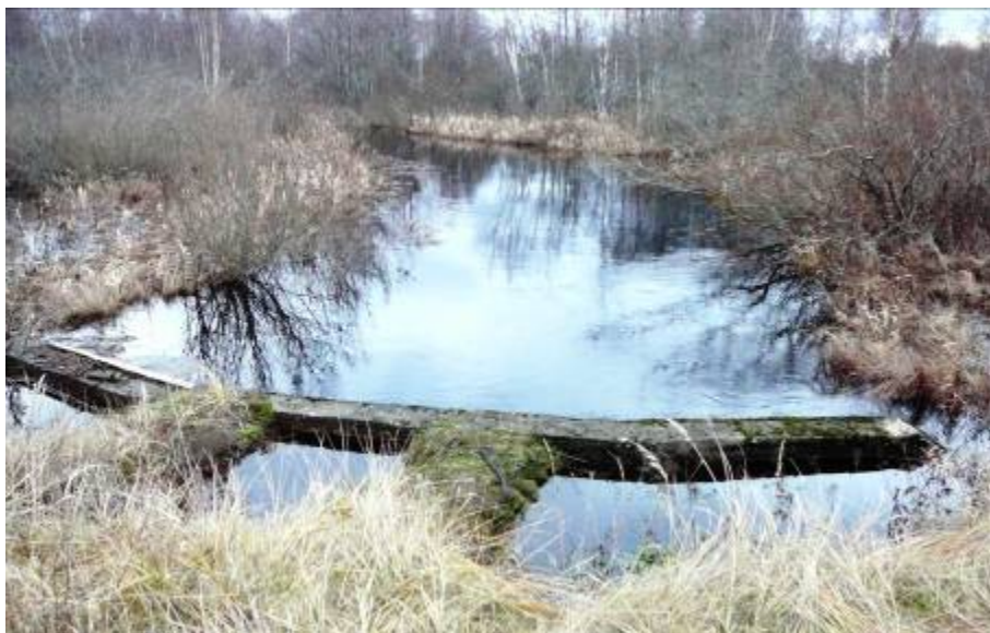
Caurteka C-14, caurteka darbojas apmierinoši, gala stiprinājumi apmierinoši, vēlams piebērt ceļa nogāzes līdz gala stiprinājumiem.
