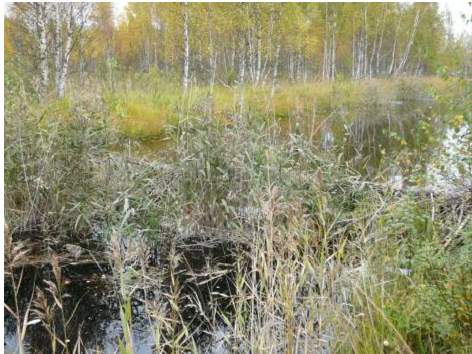
Bebru aizsprosts uz Rāmpurva grāvja augšpus caurtekai C-50.
